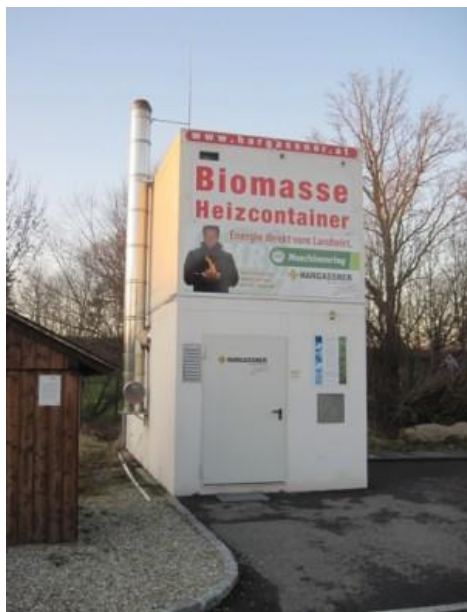
Obr. 2 Lidová škola Weng, Turn - Dvoupatrový kontejner na štěpku, výkon kotle 150 kW
